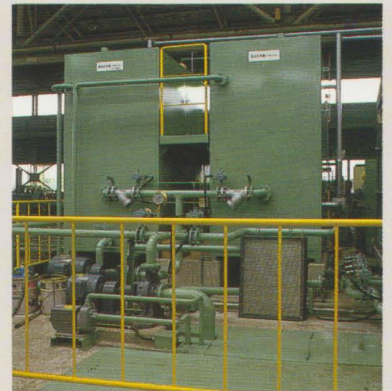
■洗浄槽及びポンプ
